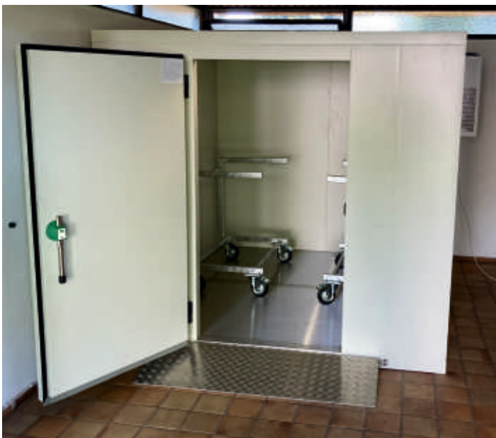
Leichenkühlzelle zur Lagerung von 4 Särgen mit fahrbaren Sargregalen
